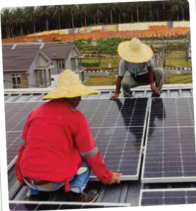
Panel Solar PV di Dewan Serba Guna, Residensi Kota Tinggi, Johor Solar PV Panels at the Multipurpose Hall, Residensi Kota Tinggi, Johor
